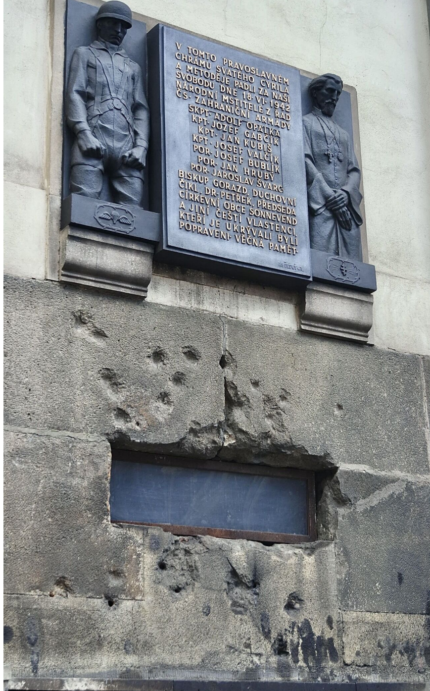
Dziury po kulach nad oknem krypty katedry świętych Cyryla i Metodego
